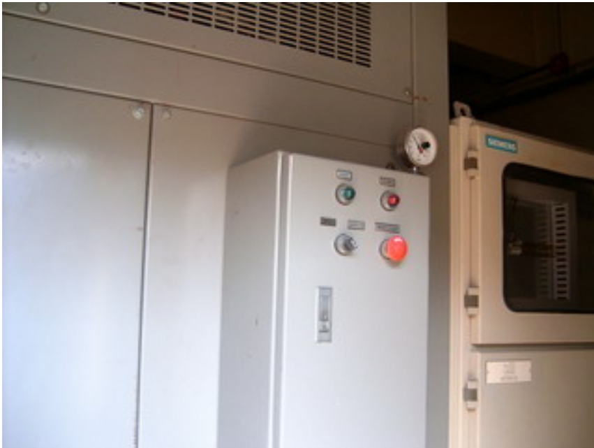
หม้อแปลงไฟฟ้า
